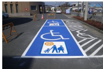
妊婦・乳幼児専用駐車スペースの設置
