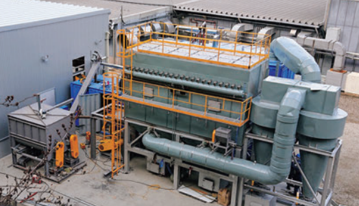
2021年2月に稼働したRPFボイラー
