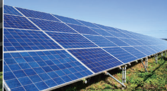
太陽光パネル
