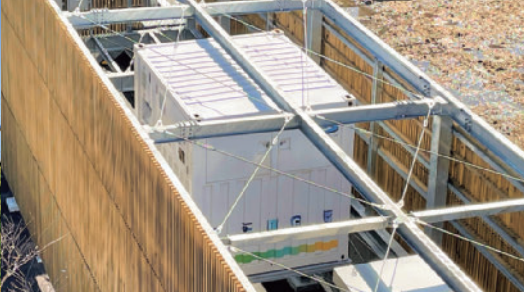
バナジウム蓄電池
