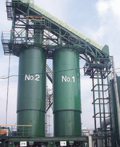
アスファルト合材プラント
